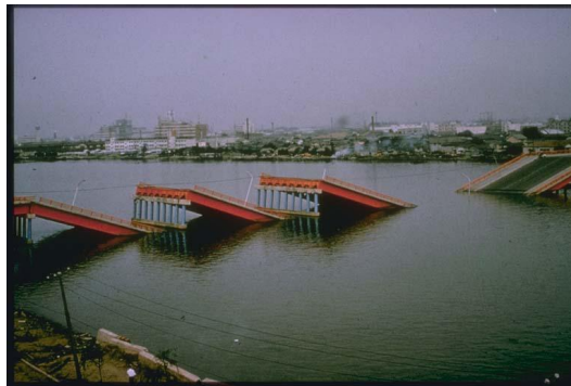
شکل 1- خرابی پل شووا در زلزله نیگاتا [3]
